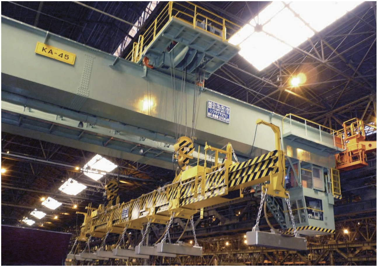
製鉄所向 マグ下 27/10t×28m 天井クレーン
